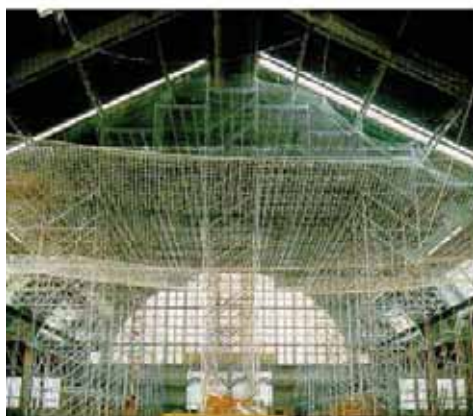
Fig. 9.2.3-2 Esempio di utilizzo di un sistema S (coperture di grandi capannoni industriali)
