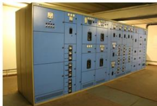
Quadro Generale di Bassa Tensione
