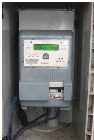
Figura n. 6 Contatore di energia elettrica per distribuzione in bassa tensione monofase.
