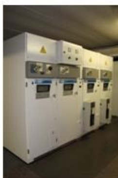
Quadro di Media Tensione
