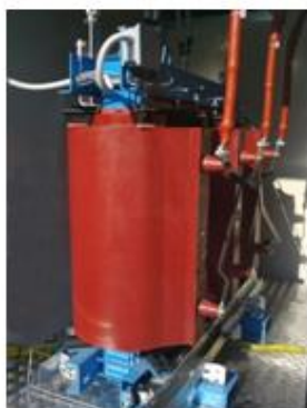
Trasformatore Media/Bassa Tensione
