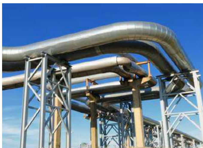
Figura 29 - Esempio di tubazione su struttura di supporto
