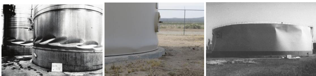
Figura 25 - Tipici danni prodotti dal sisma sui serbatoi
