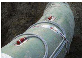
Figura 37 – Strain gauges installati su tubazioni
