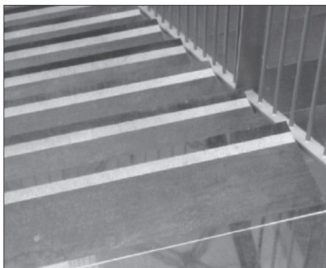
Fig. I.3-2: Per ridurre le caratteristiche di scivolosità di una superficie è possibile intervenire con apposite lavorazioni atte ad aumentarne il coefficiente di attrito.
