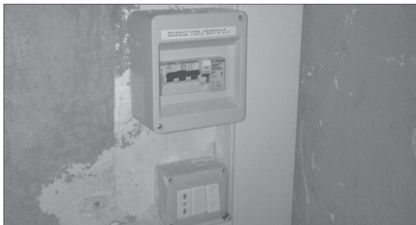
Fig. I.3-17: Interruttore generale per locali garage.
