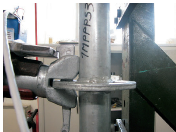
Figura 4.2.2.4-5: Evidente imbozzamento del montante
