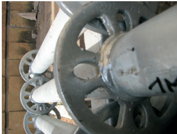
Figura 4.2.2.1-4: Fine prova Deformazione permanente del montante al contatto con la forchetta – dettaglio 2
